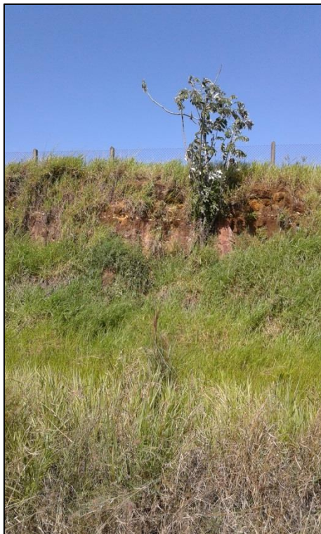
Foto 16 – Vista Geral do perfil de solo de alteração das rochas da Formação Resende – Ponto P17.
